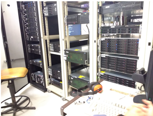
Figura: Racks de servidores.
